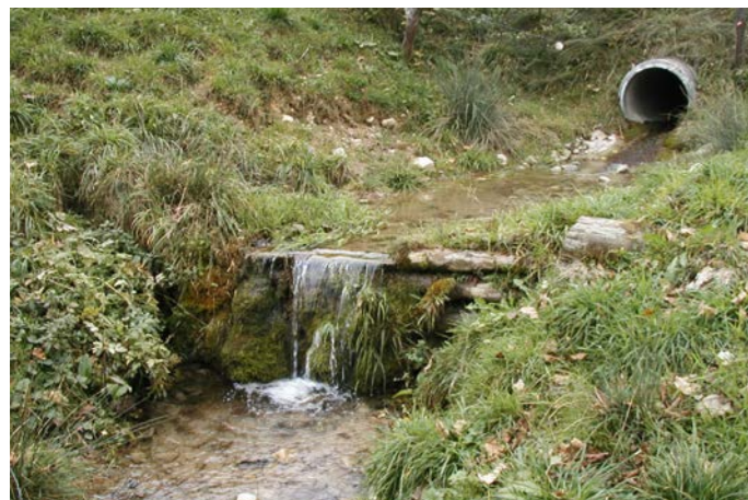
Kleiner Wiesenbach mit Geschiebeansammlung im Rückstau einer Verbauung (Mosnang).
