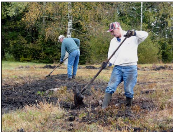
Abb. 23: Torf wird von Hand eingefüllt, und auch die Vegetationsziegel werden von Hand gesetzt. 20.10.2005
