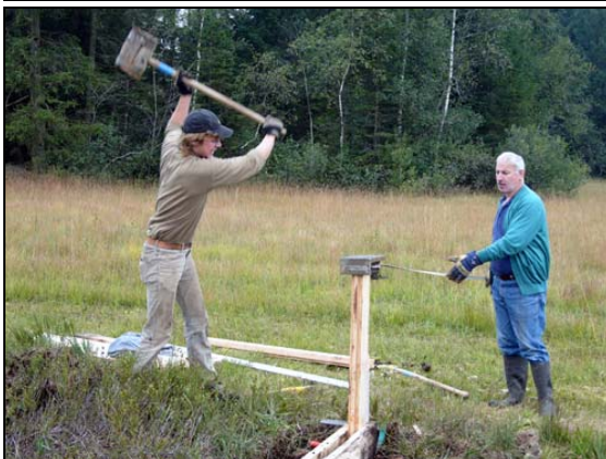
Abb. 13: Besonders schwierig war das Einrammen der ersten Bohle einer Spundwand. Der Beginn erfolgte mit den Zaunschlegel. Zum Schutz der Bohlen vor dem Zersplittern kam ein Schutz aus Eisen zum Einsatz. 28.8.2005
