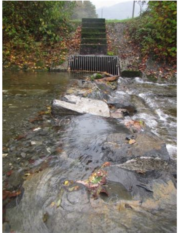
Umbau im Bereich der seitlichen Entnahme am Neulauf Berschnerbach: Durch das Einbringen von höheren Steinen springt die Entnahme früher an und garantiert einen kontinuierlichen Wasserfluss in den Altlauf (28.10.2019).
