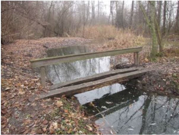
Der Fussweg wird weiterhin im Bereich des alten Querdammes geführt. Der Handlauf wurde instand gestellt (05.12.2019)
